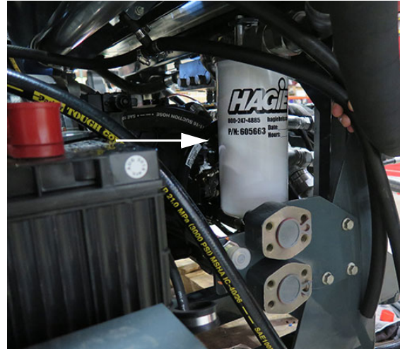
Filtre de retour au carter 1 (situé sur le côté droit de la machine, près de la batterie) - Vue typique
