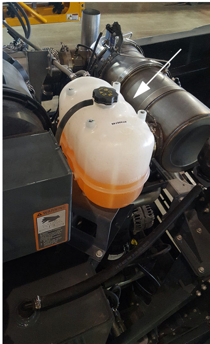
Réservoir d'équilibre - STS10/STS12 (situé vers l'arrière de la machine - ouvrez le capot pour y accéder) - Vue typique
