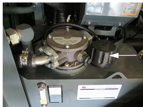
Bouchon de reniflard - STS10/STS12 (situé sur le dessus du réservoir d'huile hydraulique) - Vue typique
