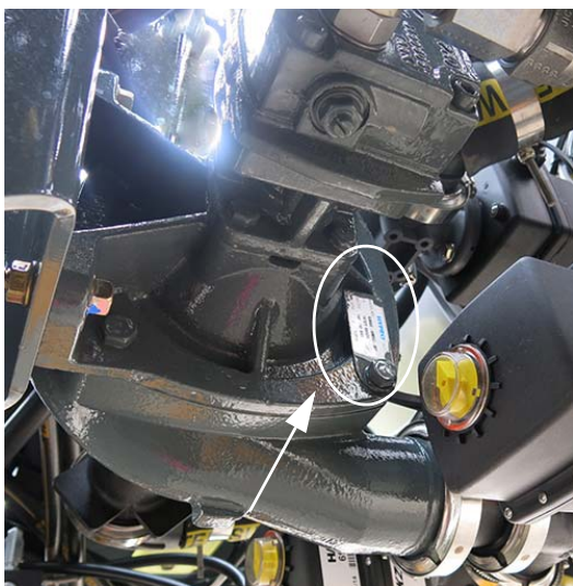
Plaque d'identification de la pompe à solution
