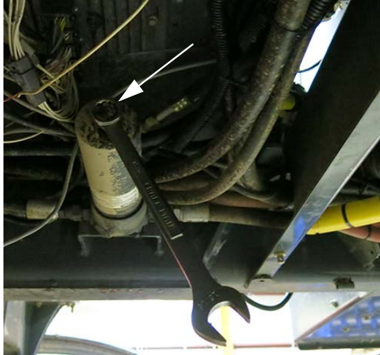
Boîtier du filtre sous pression (situé sous le côté droit de la cabine - ouvrez le capot pour y accéder) - Vue typique
