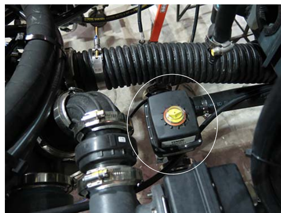
Vanne de brassage (située dans la partie centrale de la machine) - Vue typique
