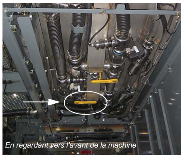
Vanne d'arrêt manuelle du réservoir 1 (située sous la partie centrale de la machine) - Vue typique
