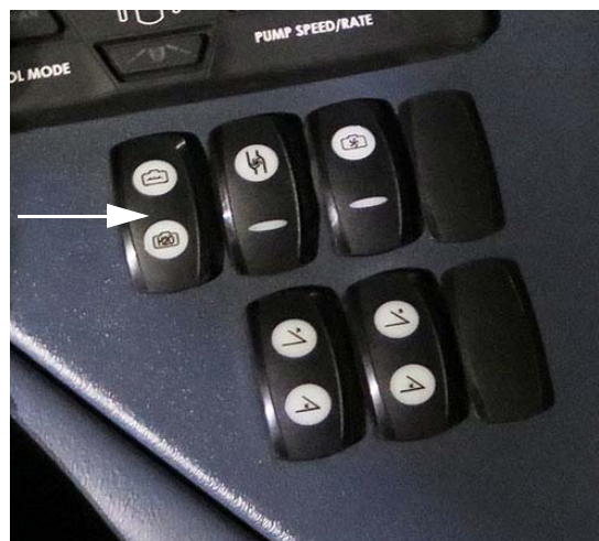
Commutateur de sélection des vannes des réservoirs (situé sur la console latérale) - Vue typique
