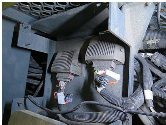
Fusibles d'alimentation des capteurs arrière (situés sous la machine près de la roue arrière droite) - Vue typique
