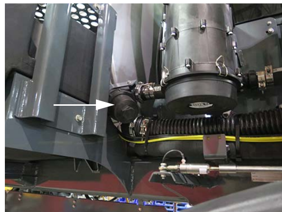
Crépine en ligne de la solution - Secondaire (située près de l'avant droit de la machine) - Vue typique
