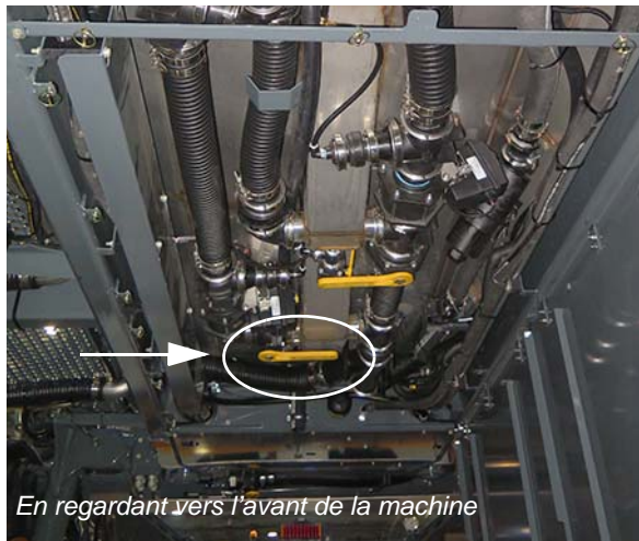
En regardant vers l'avant de la machine Vanne d'arrêt manuelle du réservoir 1 (située sous la partie centrale de la machine) - Vue typique
