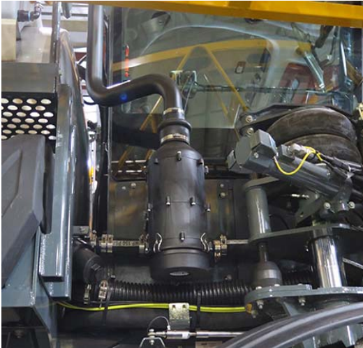
Système de filtration de la cabine (situé sur le côté droit à l'extérieur de la cabine) - Vue typique
