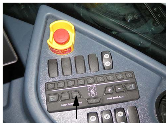
Commutateur de commande manuelle (« MAN ») du dosage (situé sur la console latérale) - Vue typique
