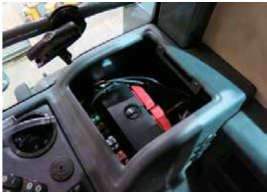
Megszakítók/biztosítékok (belül) (oldalsó vezérlőpult hátulján – a tálca levételével férhet hozzá) – Tipikus nézet
