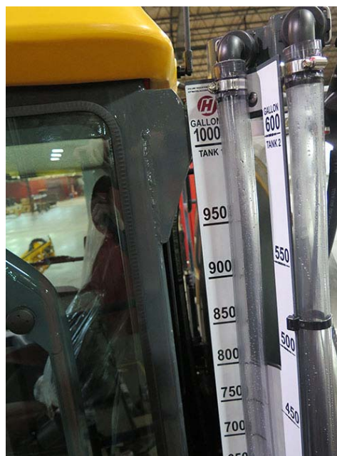
Kettős permetlé tartály oszlopos folyadékszintmérő (a vezetőfülke mögött bal kéz felől) – Tipikus nézet
