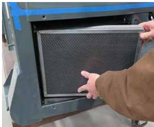
Угольный фильтр (расположен за эксплуатационной панелью наружной обшивки с правой стороны кабины) - стандартный вид
