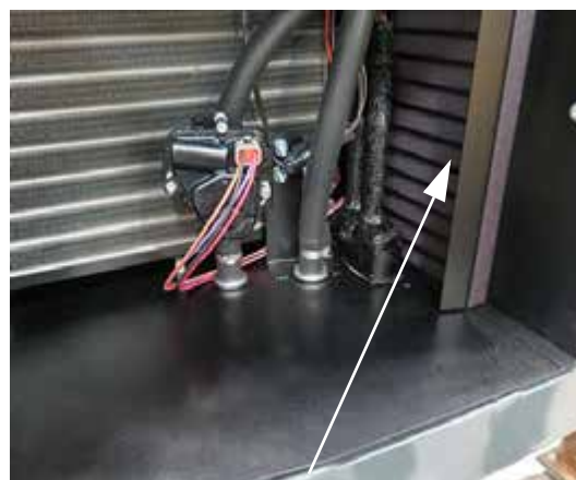
Циркуляционный фильтр (расположен вдоль задней правой стороны технического отсека) - стандартный вид
