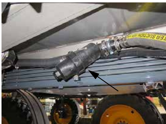
Сетчатый фильтр затворной линии (расположен в центре под правой стороной машины) - стандартный вид
