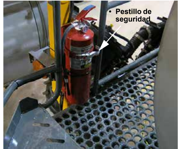
Extintor de incendios (ubicado a lo largo de la plataforma en el lado izquierdo de la máquina) -Vista típica
