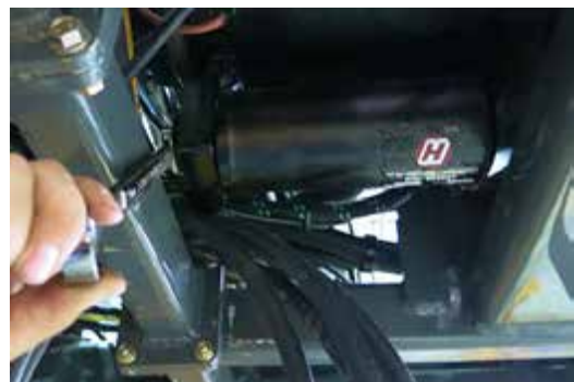
Filtro de la bomba de carga (situado debajo de la bomba impulsora) -Vista típica
