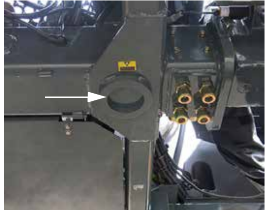
Anillo de contención del punto de elevación (ubicado en el bastidor cerca de cada pata) -Vista típica
