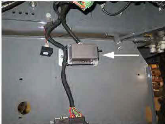
Permetlé szivattyú relé tartódoboz (A fülke elülső vége alatt helyezkedik el - hozzáférés az alsó panelen keresztül) – Tipikus nézet
