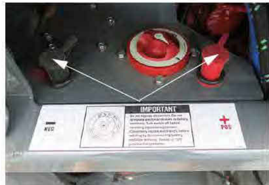
Kiegészítő akkumulátortöltő csatlakozó (a hátsó alvázkereten) – Tipikus nézet
