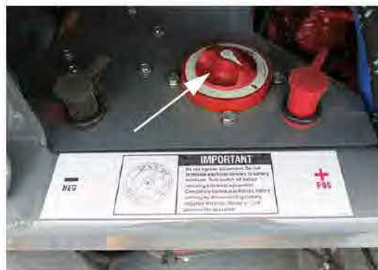
Sectionneur général de la batterie (situé sur le châssis principal arrière) - Vue typique
