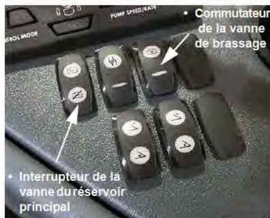
Commutateurs de la vanne du réservoir principal et de la vanne de brassage (situés sur la console latérale) - Vue typique
