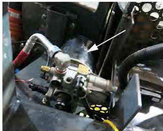
Dessiccateur d'air (situé en dessous de la plate-forme, du côté droit de la machine) - Vue typique
