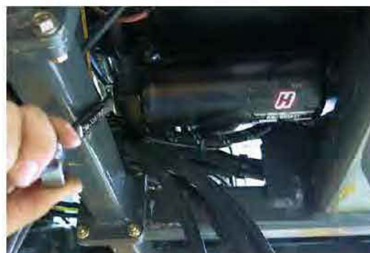
Filtre de la pompe de charge (situé sous la pompe d'entraînement) - Vue typique
