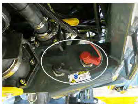
Prises électriques (à proximité du dispositif de remplissage par l'avant) - Vue typique
