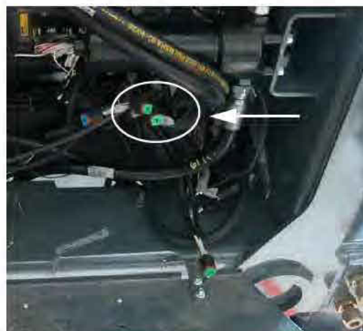
Connexions d'entrée pour caméra (situées en dessous de la cabine - retirez le panneau pour y accéder) - Vue typique
