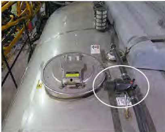
Crépine de rinçage du réservoir (située sur le haut du réservoir de solution) - Vue typique
