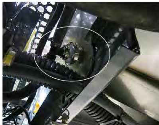
Agitateur à jet (situé à chaque extrémité du réservoir de solution) - Vue typique
