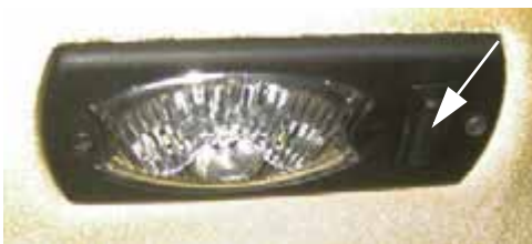
Belső munkalámpa kapcsoló – Tipikus nézet
