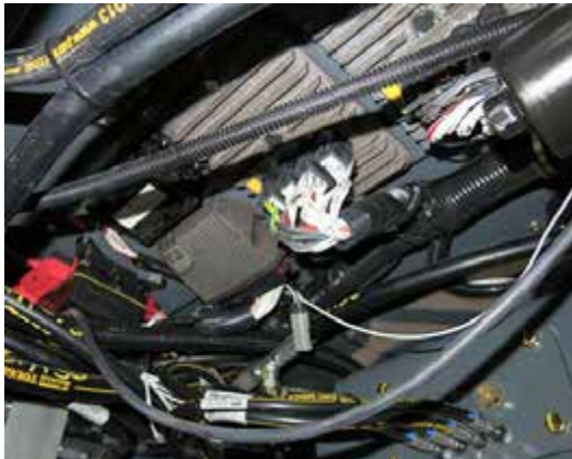
Megszakítók/biztosítékok (kívül) (a fülke alatt – panel levételével férhet hozzá) – Tipikus nézet
