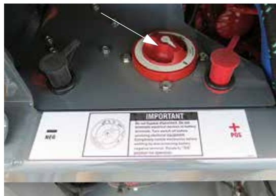
Akkumulátor megszakító kapcsolója (a hátsó alvázkereten) – Tipikus nézet
