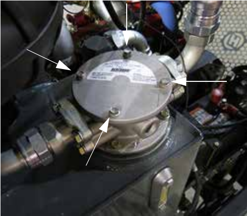
Carcasa del filtro de retorno (ubicada en el lado derecho de la máquina cerca del depósito de aceite hidráulico) -Vista típica
