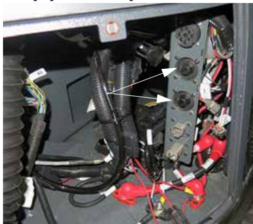
Puertos de diagnóstico Hagie (2) (ubicados en el interior de la consola lateral - retire el panel frontal para acceder) -Vista típica
