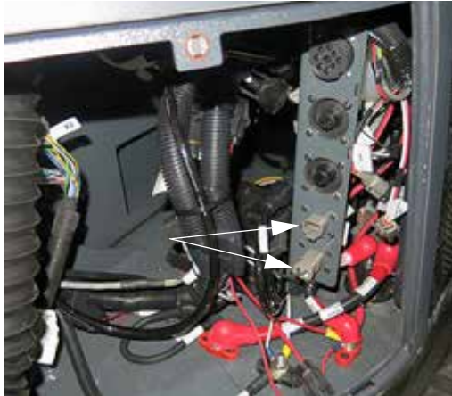
Conectores de alimentación de 4 pines (2) (ubicados dentro de la consola lateral- retire el panel frontal para acceder) -Vista típica
