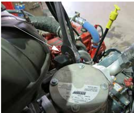
Manguera de drenaje de la carcasa (situada cerca de la parte superior del depósito hidráulico) -Vista típica
