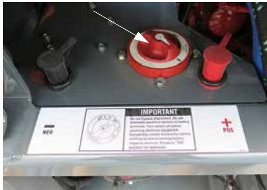
Interruptor de desconexión de las baterías (ubicado en el bastidor principal trasero) -Vista típica
