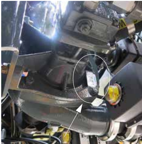
Placa de identificación de la bomba de solución
