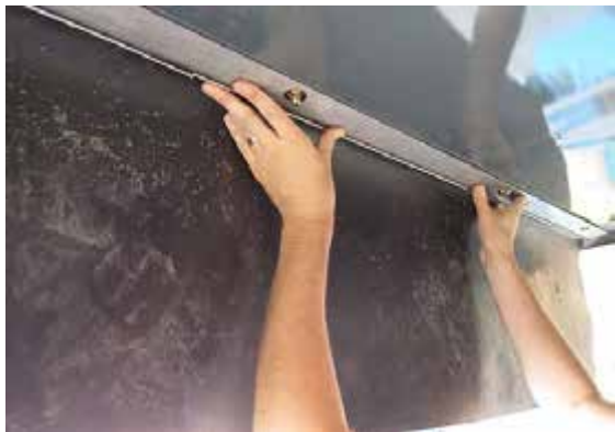
Súrolásvédelmi gumifüggöny telepítés – Tipikus nézet
