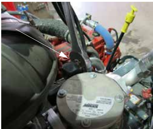
Manguera de drenaje de la carcasa (situada cerca de la parte superior del depósito hidráulico) -Vista típica
