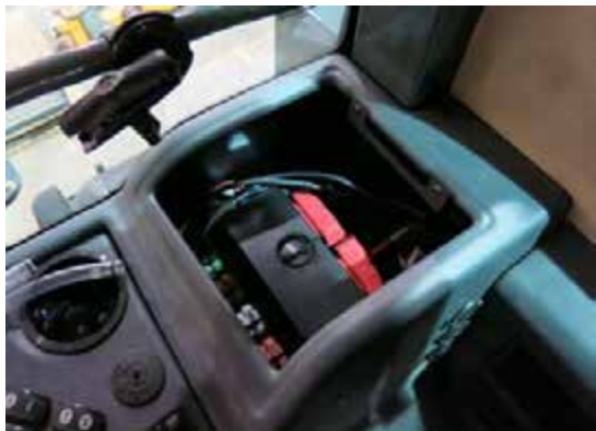
Interruptores automáticos / fusibles (interiores) (ubicados en la parte trasera de la consola lateral; quite la bandeja para tener acceso) -Vista típica
