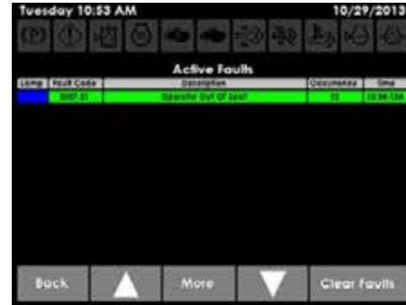
Pantalla de fallas del sistema
