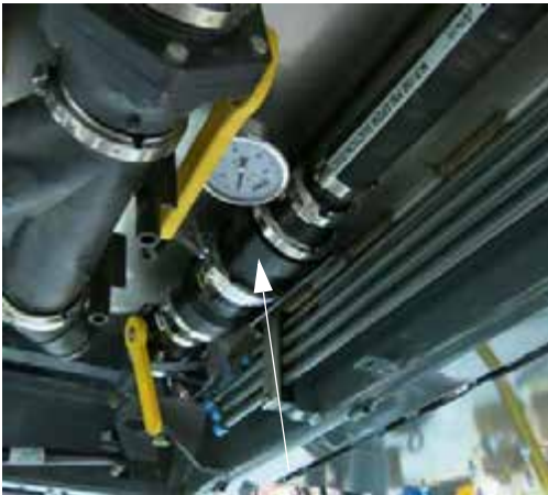
Medidor de flujo -Vista típica
