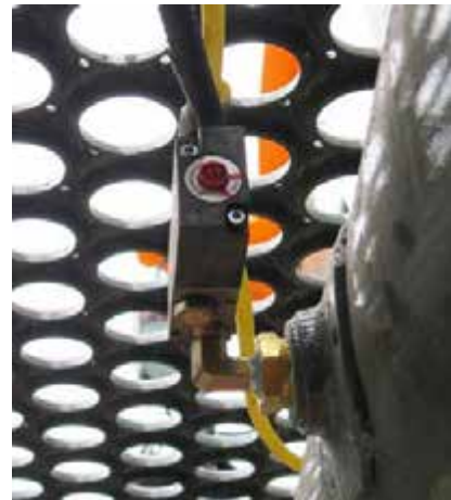
Válvula de control piloto (situada cerca del tanque de aire) -Vista típica
