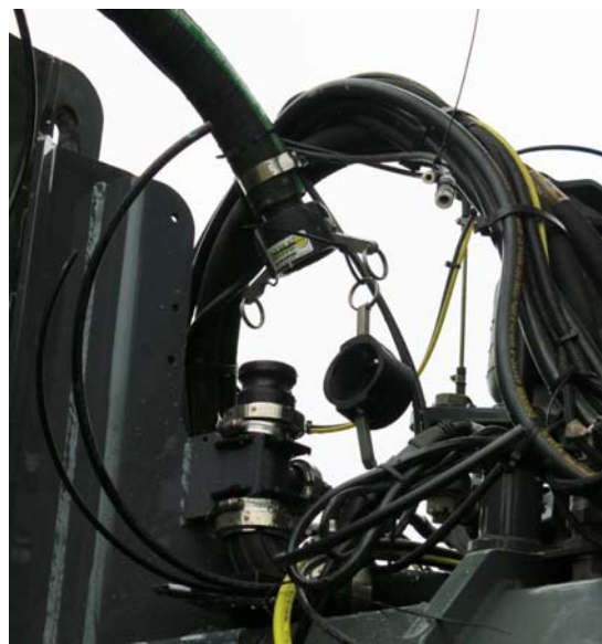
Permetezőszer vezeték csatlakoztatása (a gép elülső jobb oldalánál helyezkedik el) –Tipikus nézet
