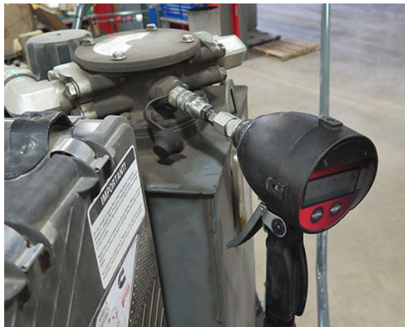
Llenado del tanque a través del puerto de llenado de aceite hidráulico -Vista típica
