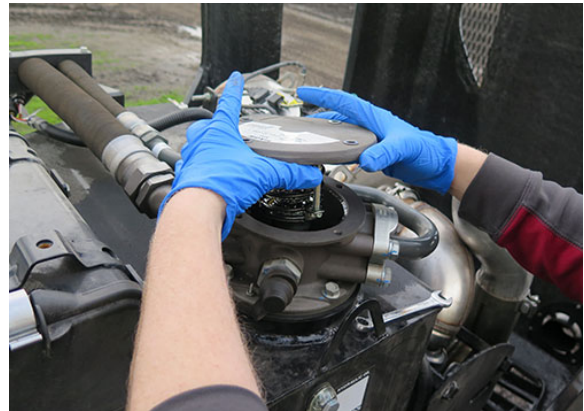
Llenado del tanque a través del receptáculo del filtro de retorno hidráulico -Vista típica
