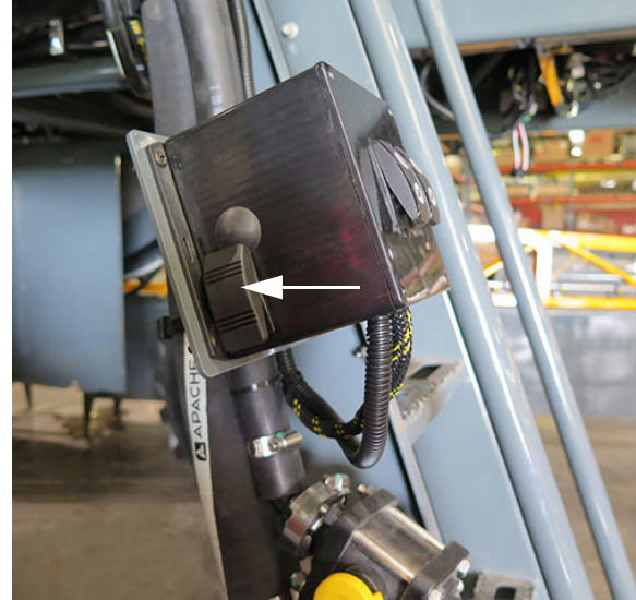
Interruptor de luces de plataforma (ubicado en el lateral de la caja de interruptores cerca de la escalera) - Vista típica
