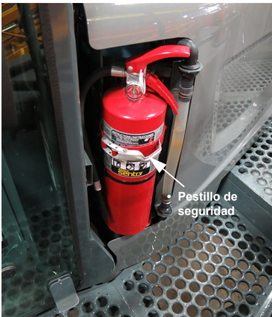
Extintor de incendios (ubicado debajo del lado izquierdo de la cabina) -Vista típica
