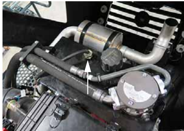
Sensor de nivel/temperatura (ubicado encima del depósito de aceite hidráulico) -Vista típica
