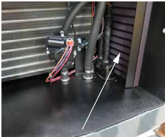
Filtro de recirculación (Ubicado a lo largo del lado derecho del compartimento) -Vista típica
