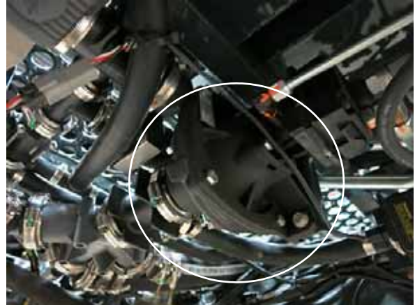
Bomba de solución (ubicada debajo del centro de la máquina) -Vista típica
