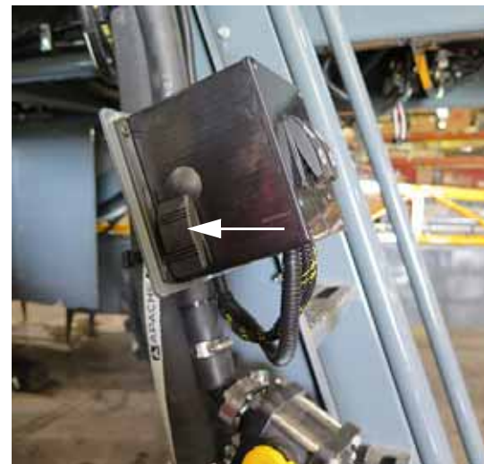
Interruptor de aspersión nocturna (ubicado en el lateral de la caja de interruptores cerca de la escalera) -Vista típica
