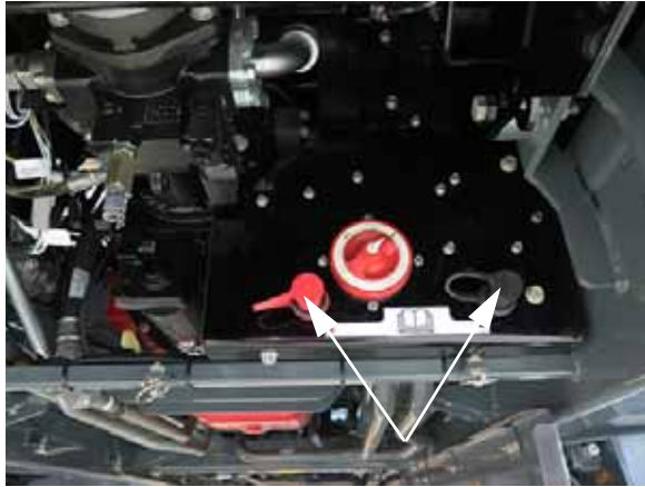
Bornes de carga auxiliar de la batería (ubicados en la parte posterior del chasis principal) -Vista típica
