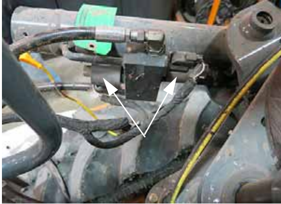
Válvulas de bloqueo -Vista típica
