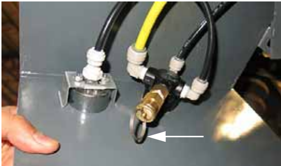
Anillo de la válvula de alivio de presión (ubicado en la parte posterior del regulador de presión de espuma) -Vista típica
