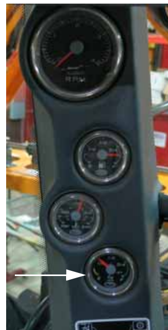
Medidor del DEF (ubicado en el poste A de la cabina) -Vista típica
