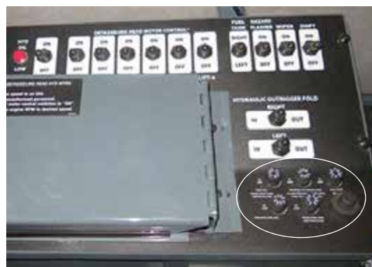
Siguranțe (pe consola laterală) - Vedere tipică
