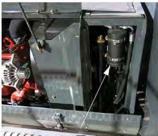
Receptor/Secador do sistema de A/C (Localizado atrás da cabina perto do radiador - remova as grelhas do radiador para acessar) -Vista típica
