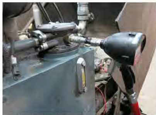
Abastecendo o tanque pela porta de abastecimento de óleo hidráulico -Vista típica
