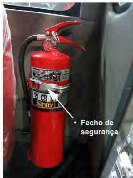
Extintor de incêndio (localizado ao lado do assento do operador) -Vista típica
