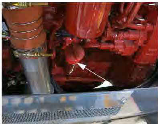
Porta de enchimento do óleo do motor remota (Localizada perto do lado esquerdo do motor - abra o capô para acessar) -Vista típica
