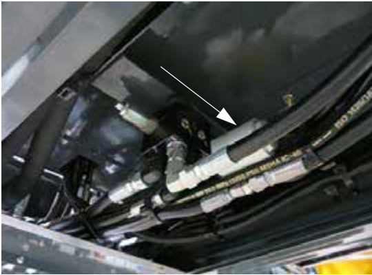
Filtre haute pression en ligne (situé en dessous la machine - faire glisser la grille de protection pour l'enlever et accéder au filtre) - Vue typique
