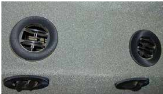
Buses d'aération - Vue typique
