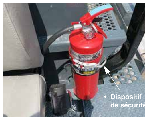
Extincteur d'incendie (situé le long du côté du siège de l'opérateur) - Vue typique
