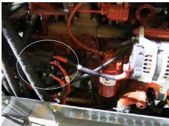
A kábelkötegek árammegszakítói és biztosítékai (A motor bal-kéz felőli oldalán) - Tipikus nézet
