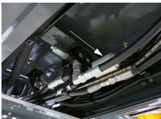
高压在线过滤器 (位于机器下方 - 将屏盖向外滑出， 可以够着) - 典型视图
