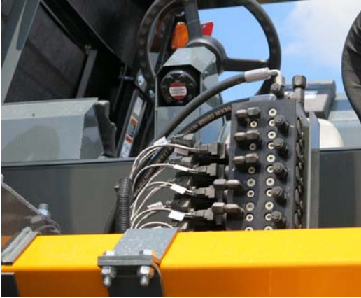
电动液压阀 (位于横梁的前端) - 典型视图
