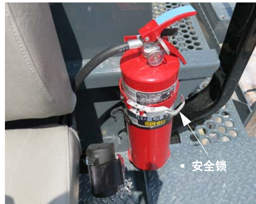
灭火器 (位于操作员座椅的侧面) - 典型视图
