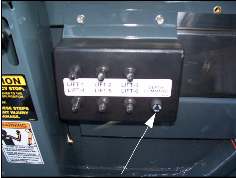
Derinlik Komutu Sigortası (Kaldırma Anahtarı Panelinde) -Genel Görünüm
