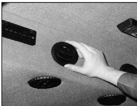
Ventile de aerisire –Vedere tipică
