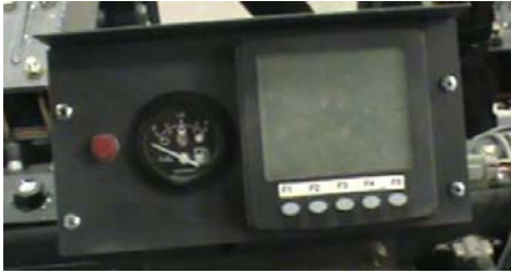
Indicator nivel combustibil –Vedere tipică
